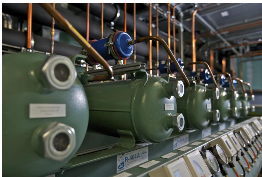
Bild 3: Kälteanlage Klinikum Klagenfurt
