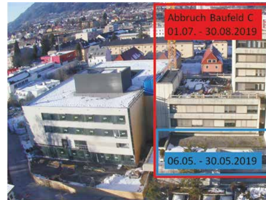
Während der Bauarbeiten bleibt die direkte Verbindung zwischen Neubau und dem Rest des Krankenhauses gekappt.
